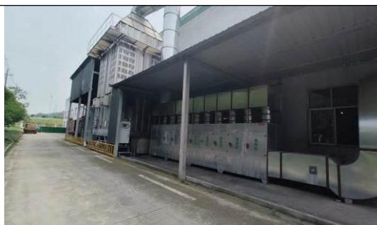
线绳车间外废气处理设施
